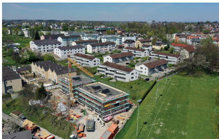
ARBON AM BODENSEE Vier moderne 6½-Zimmer-Eckhäuser Mit grosszügiger Raumeinteilung Preis: ab Fr. 1'325'000.- Zuständig: Concetta Bollinger
